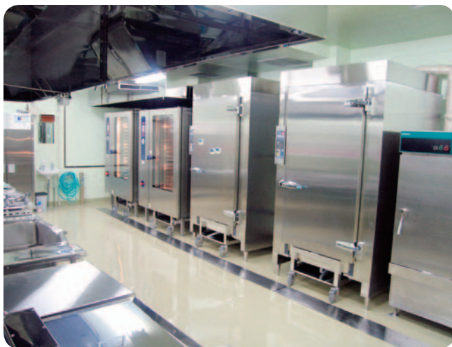
オール電化されたセントラルキッチンの内部。 真空調理法を採用
